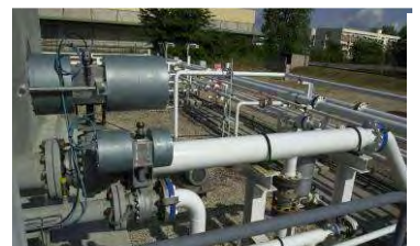
Canalisation équipée de vannes de sécurité
